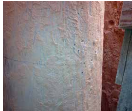
Figura 20 – Dano (trinca) confirmado após escavação da estaca E55H
