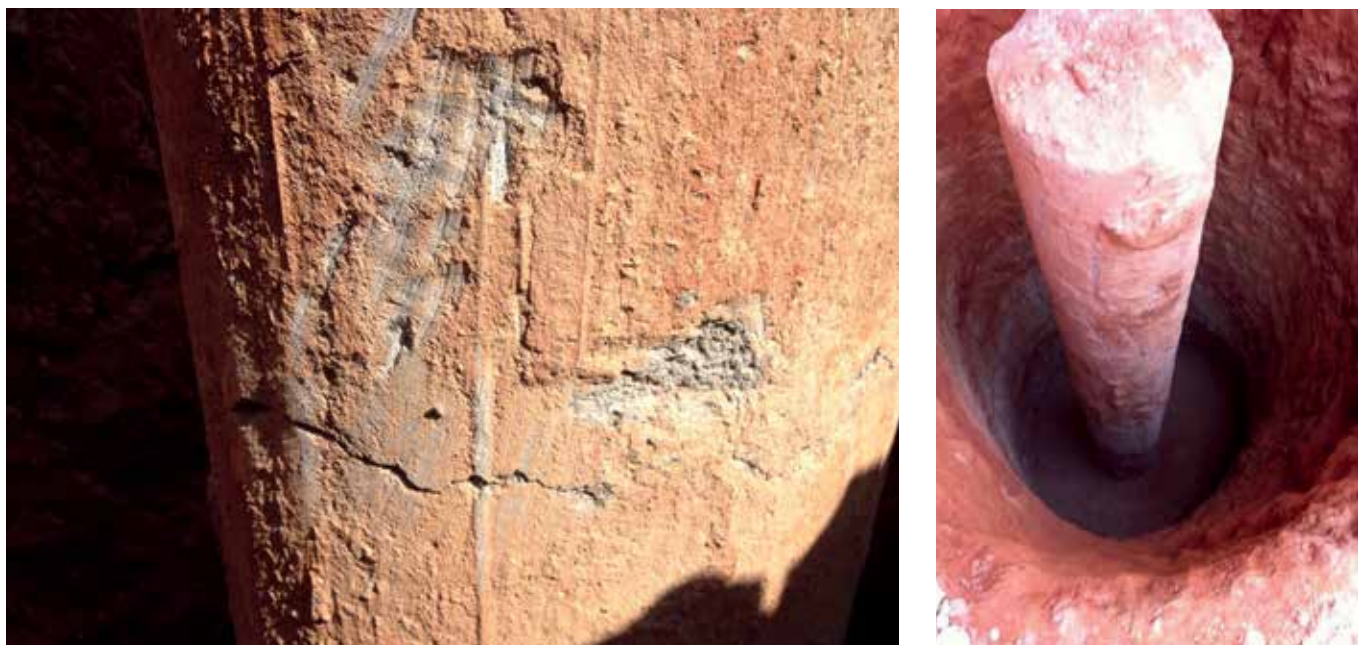
Figura 14 – Fissura verificada após escavação
