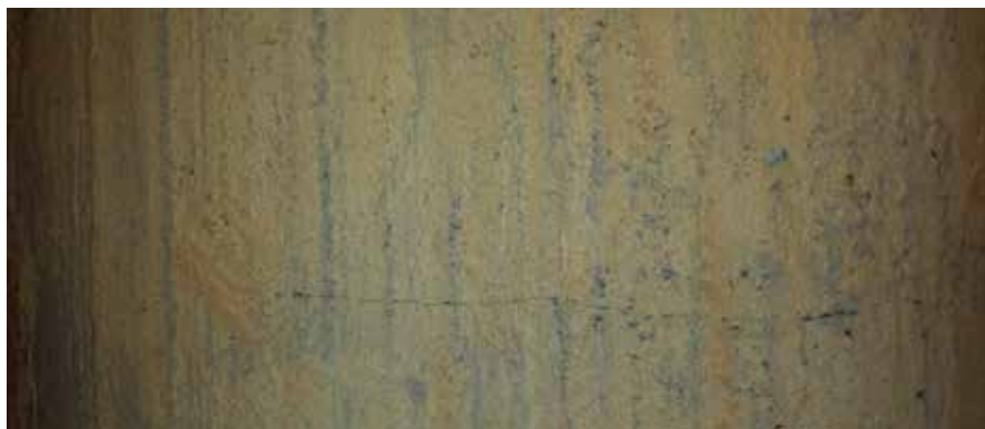
Figura 19 – Dano (trinca) confirmado após escavação da estaca E55G
