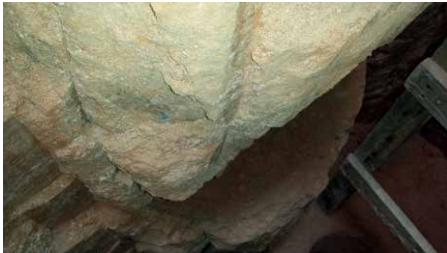
Figura 18 – Dano confirmado após escavação da estaca E49B
